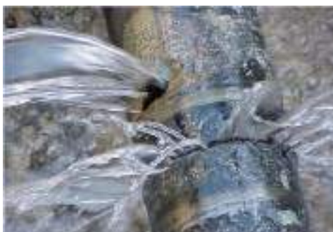
Рис. 4.30. Потери воды на магистральном водопроводе
